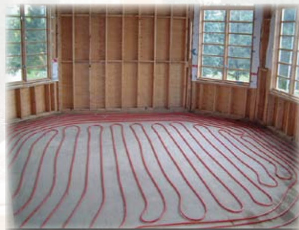
Chauffage au sol
